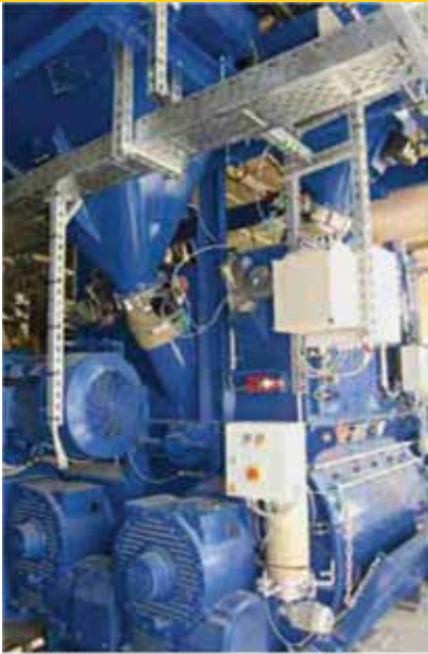
There is a lot of space on the new mixer platform due to the compact design of the twin-shaft batch mixer. Der Doppelwellen-Chargenmischer bietet durch seine kompakte Bauweise viel Platz auf der neuen Mischerbühne.
